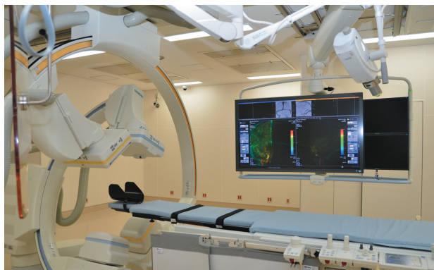
IVR センター
